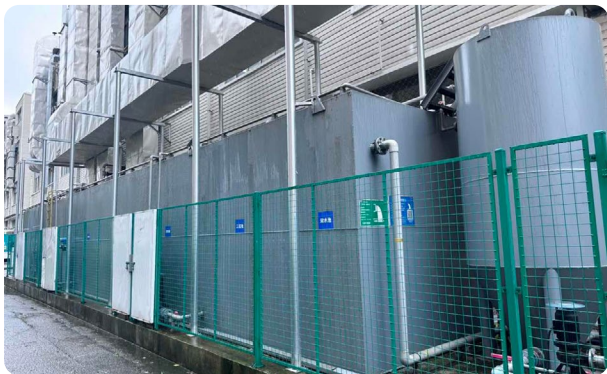
一体化污水处理装置
